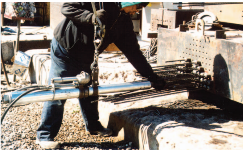
Zweischlauchspannpresse 200 kN, Hub 500 mm Fa. Bayshore, Cape Charles, Virginia USA
